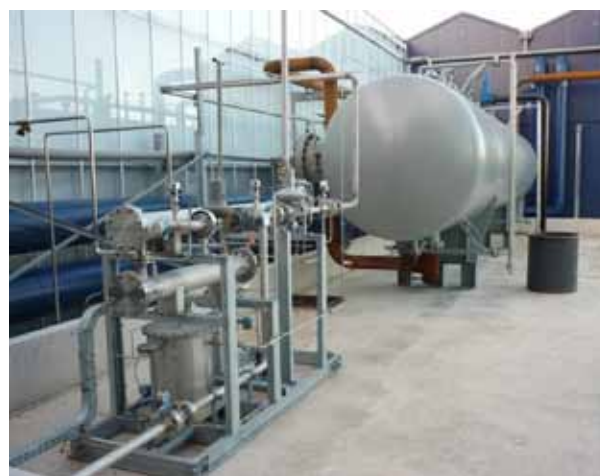
Geothermie droog & reduceerinstallatie
