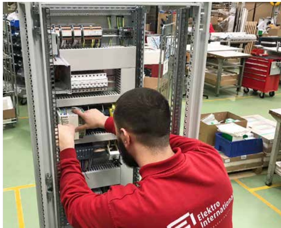
Met ondersteuning van het specialistenteam besturingstechniek van Elektro Internationaal werd een tijdelijke installatie ontworpen die tot permanente oplossingen leidt.
